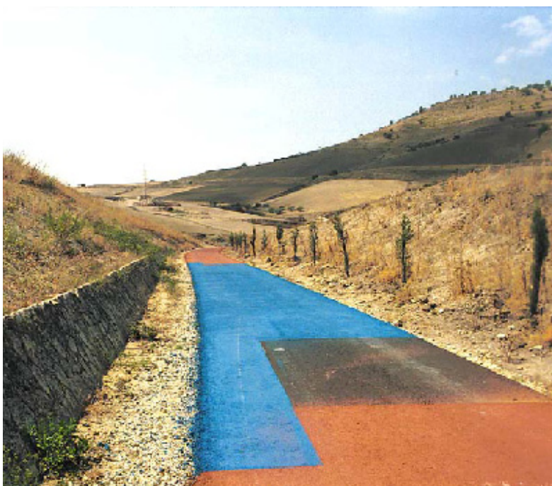
In questa pagina e nelle seguenti: immagini della pista ciclabile realizzata tra Salvatorello e S.Michele di Ganzaria (Greenway degli Erei), sul sedime della ex ferrovia Caltagirone-Piazza Armerina-Dittaino. Si veda anche la scheda n 38.
