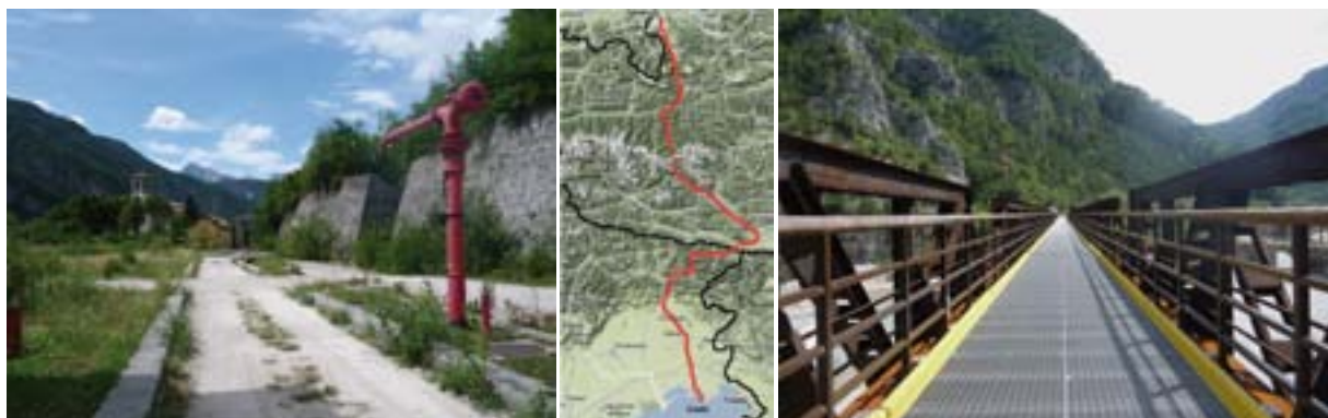
Immagine della Ciclovía Alpe Adria Radweg: lavori in corso presso la stazione di Chiusaforte e il ponte in ferro sul fiume Fella.
