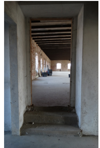
Differenza della quota del pavimento al piano primo.
