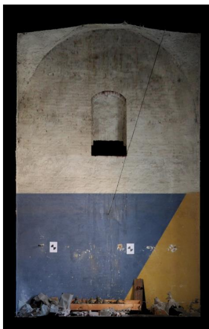
Fig. 9. Laboratorio LaRiFo, Politecnico di Milano, Polo territoriale di Mantova. Vista ortogonale della nuvola di punti di una parete della stanza sopra la campata sinistra del vestibolo. Associazione del dato radiometrico. Le prese fotografiche sono state eseguite facendo coincidere il centro di proiezione della fotocamera con quello del Laser-Scanner. Visualizzazione generata con software Pointools.
